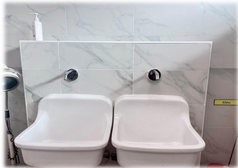
อ่างฟอกมือชนิดที่ไม่ใช้มือเปิดปิดน้ำ
